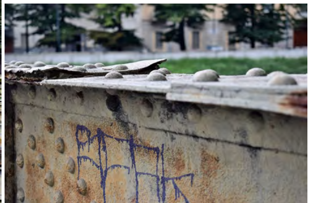
Foto 9: lungo dora firenze 21 bis. Dettaglio corrosione
