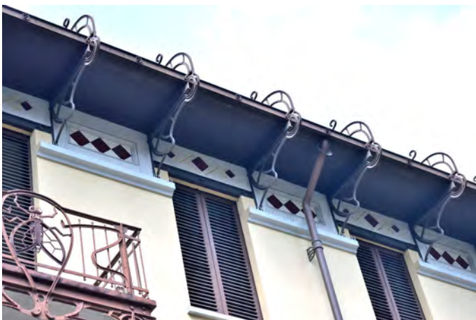
Foto 14: Via catania 35 Strutture in ferro organiche e insetti
