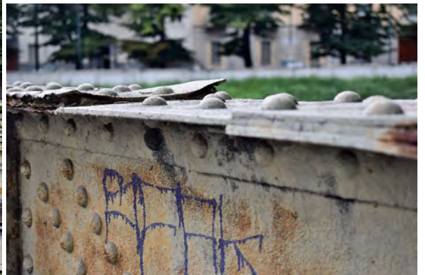
Foto 9: lungo dora firenze 21 bis. Dettaglio corrosione
